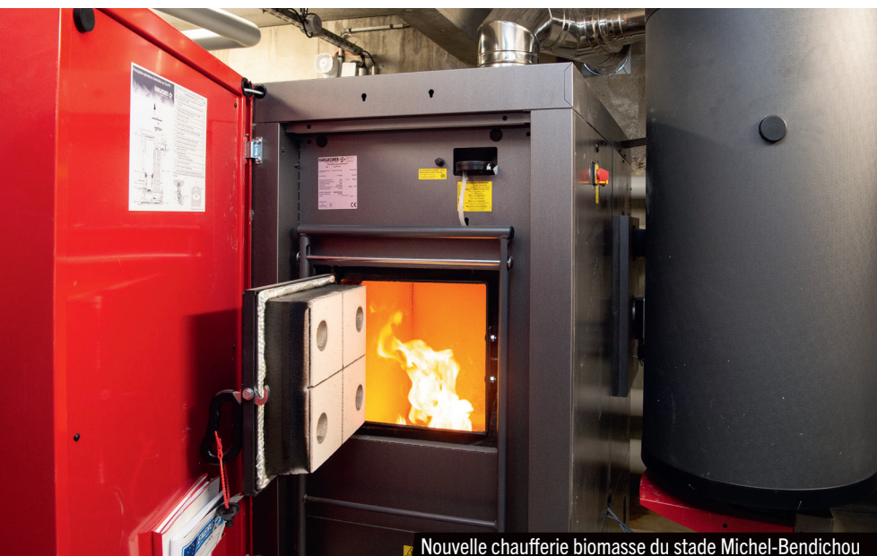
Nouvelle chaufferie biomasse du stade Michel-Bendichou
